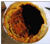
古くなった配管
